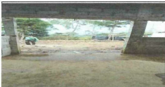
Foto 3: Observa que la necesidad de instalar una puerta grade del salon de clase. Puerta 2
